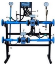
Модульный узел учета с вертикальным расположением трубопроводов
